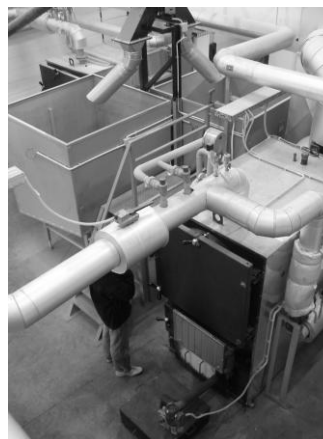
Kotłownia osiedlowa 2x350 kW
